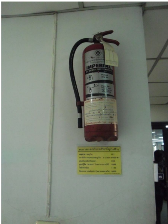
ภาพถ่ายการป้องกันอัคคีภัย
